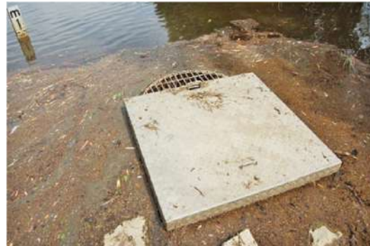
Déchets bouchant l'exutoire © Hunt et al., 2011
