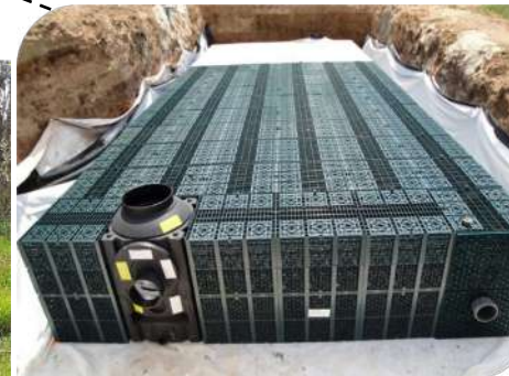
Bassin de rétention enterré © http://www.actp13.com
