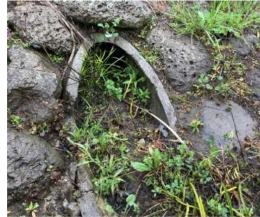
Entrée d'eau bouchée © Living Rivers
