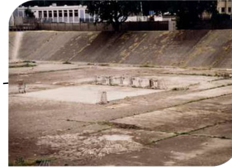
Bassin de rétention © CG93, 1995
