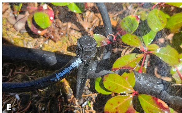
Figure 4 — Les différents types de systèmes d'irrigation utilisés dans le cadre d'ouvrages de phytotechnologies. A) Tuyau d'irrigation goutte à goutte, B) Tuyau suintant, C) Gicleur d'un système d'irrigation par aspersion, D) Irrigation manuelle, E) Gicleur à microjets.
