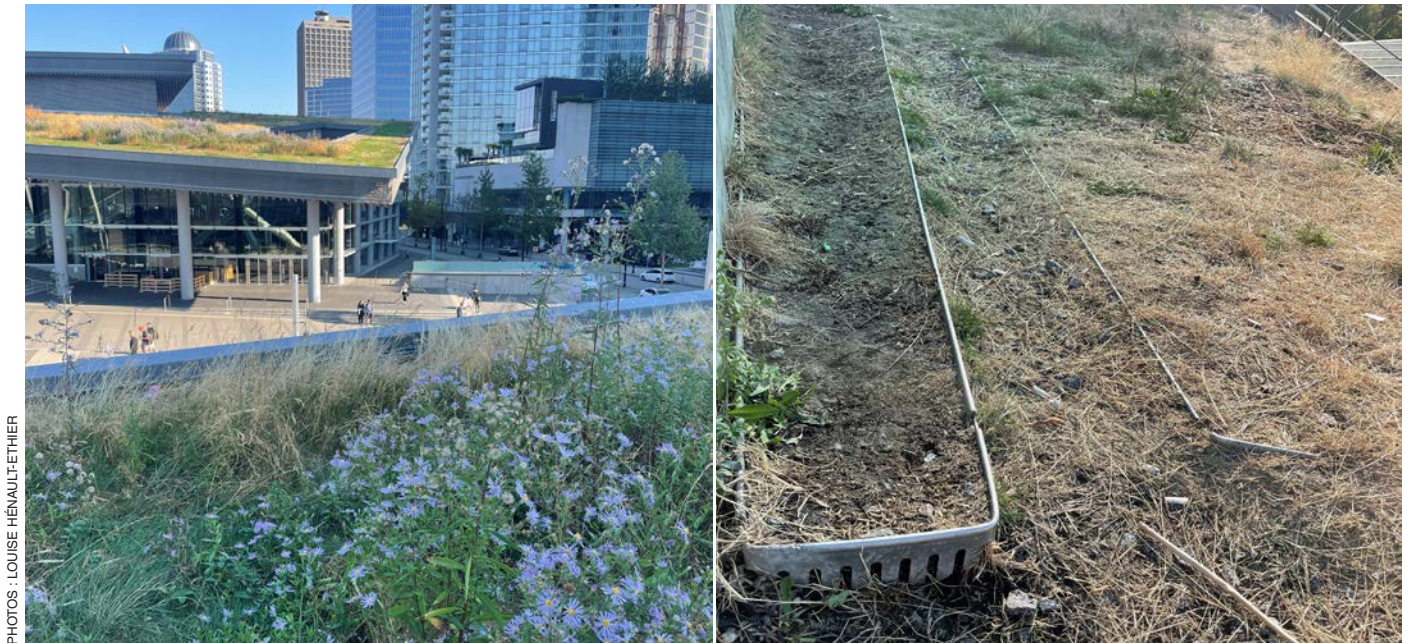
Figure 9 — Deux secteurs du même toit végétalisé, à gauche, une zone où la croissance est satisfaisante et à droite une zone où le substrat est dénudé et la végétation desséchée. Une surveillance régulière permet d'éviter ce type de difficulté avant qu'elles ne deviennent complexes à corriger.
